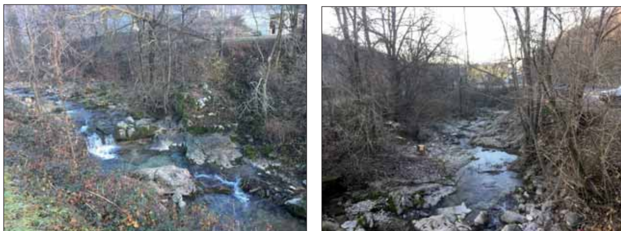
Figura 2 – Tratto nei pressi del campo sportivo prima (a sinistra) e durante (a destra) gli interventi.
