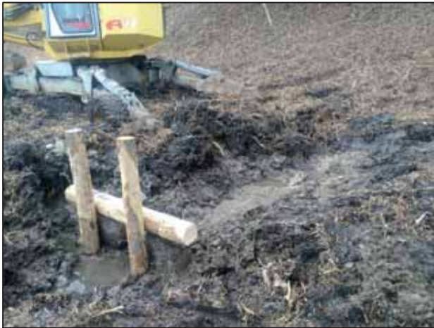
Figura 4 – Dettaglio realizzazione briglia in legname per la regolazione del livello dei punti d'acqua.
